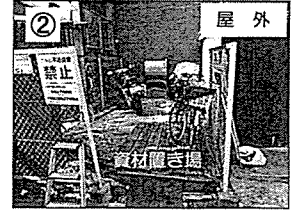
ゴミ置き場、屋外階段の間に資材置場加工場を設置いたします。
